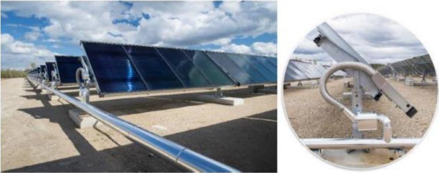
Figure 2 : A gauche vue des capteurs solaires avec tracking, à droite vue de profil du système de tracking (source : société newHeat pour le projet Condatsol)
