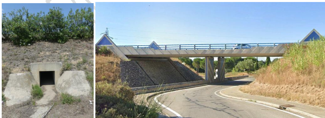
Ouvrage de franchissement de la RD618 peu favorable au passage de la faune
